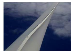
叶片开裂监测
